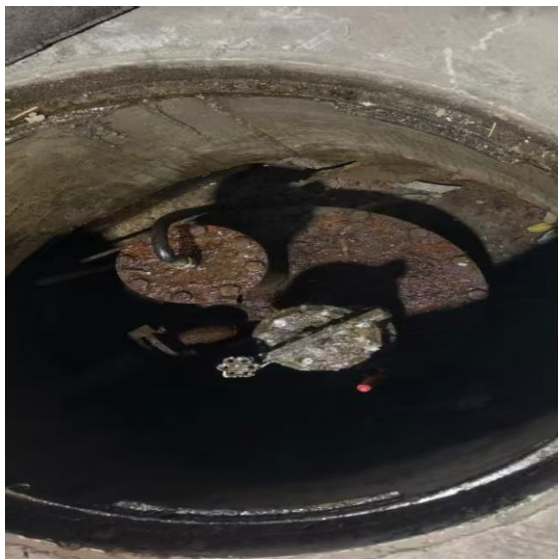
2: 油卸口腐蚀严重已整改 整改前
